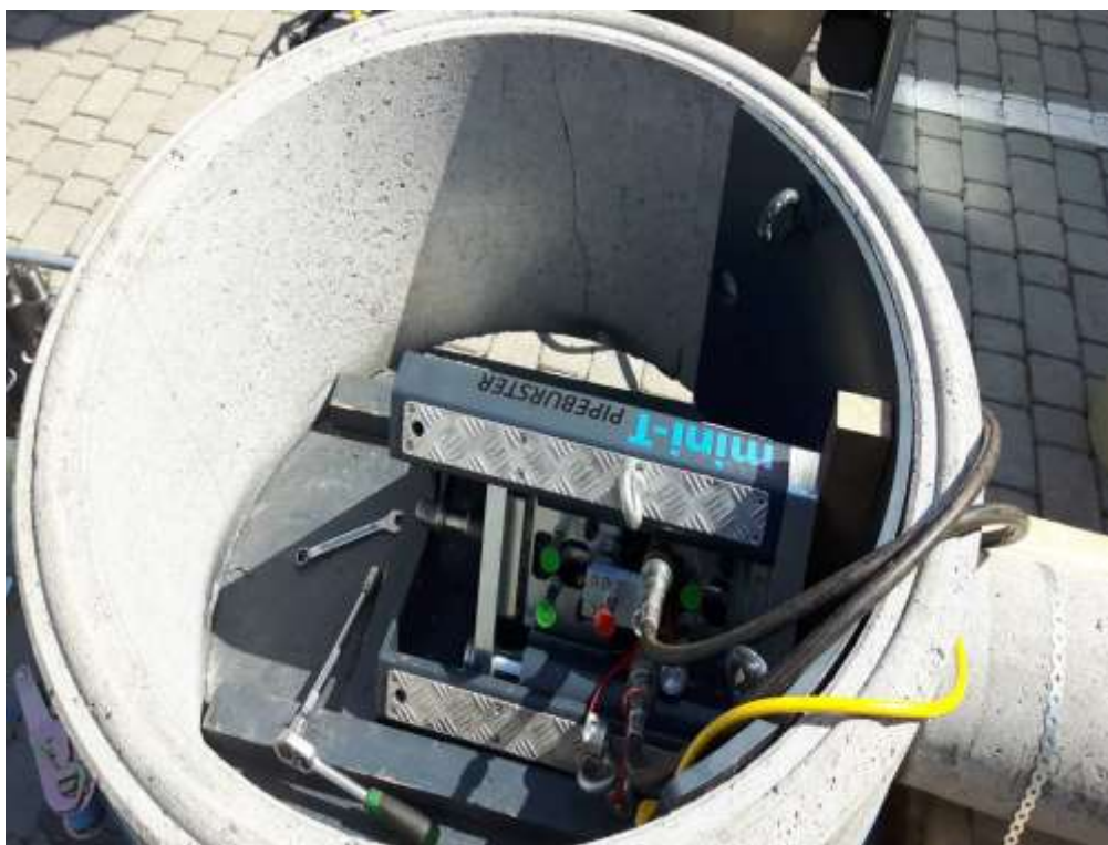
Rys. 2. Maszyna do odnowy sieci kanalizacyjnych w technologii krakingu statycznego (studniarska).
